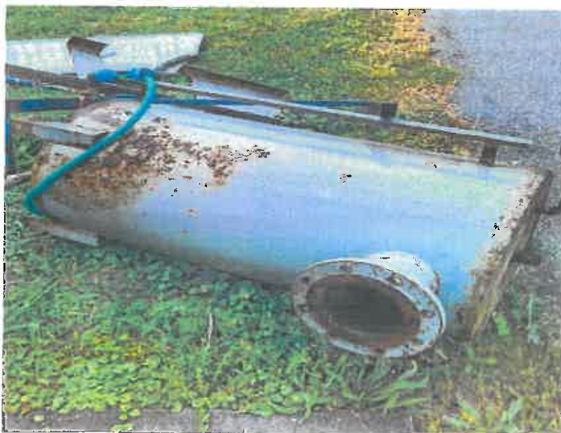
Obr. č. 3 Pohľad na plniace zariadenie
