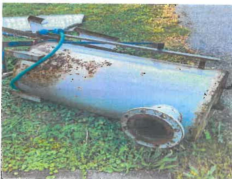
Obr. č. 3 Pohľad na plniace zariadenie
