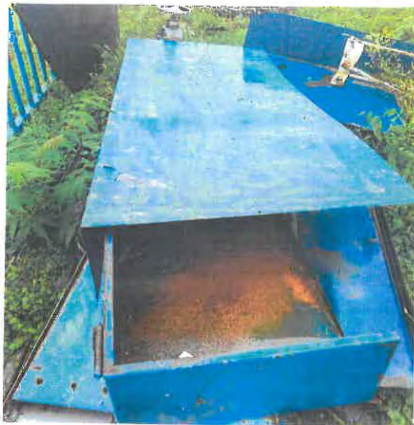
Obr. č. 4 Plechové krytie rozdeľovačov a zberačov
