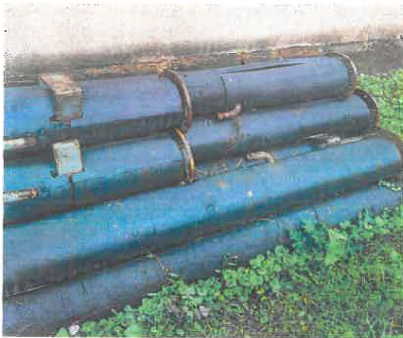
Obr. 2 Zberače s namontovanými vývodmi pre rozdeľovače
